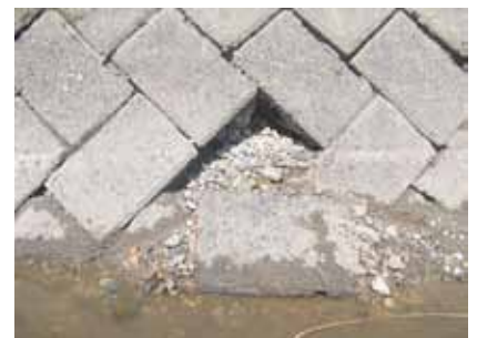
ブロック積が抜け落ちている様子
