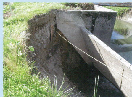
土砂流出状況 (H23. 7. 11) 堰右側の躯体背面
