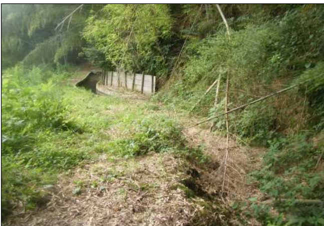
④区間：小矢部市白谷地内（H27.8 斜面崩落区間）
