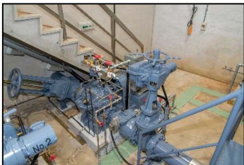
① 1号揚水機
