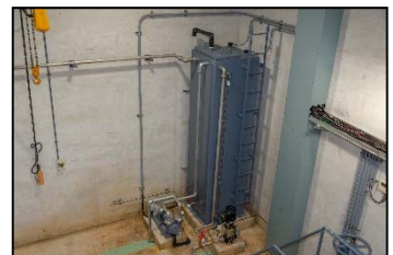
③ 封水タンク
