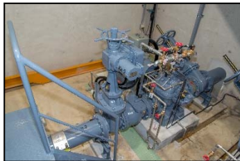
② 2号揚水機
