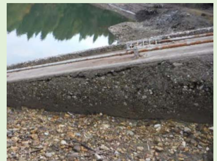
取水施設コンクリート部 （骨材の露出）
