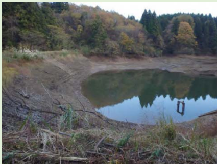
堤体上流法面（法面浸食）
