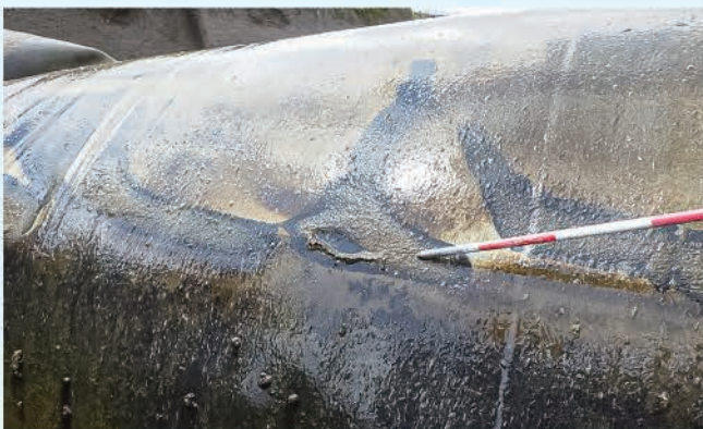
ゴム袋体老朽化状況 (H27.4.17)
