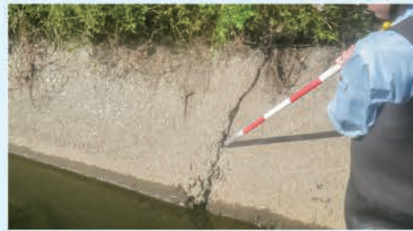
ブロック亀裂状況
