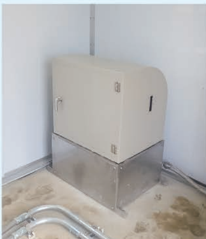
自動倒伏装置
