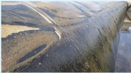
ゴム袋体の老朽化状況
