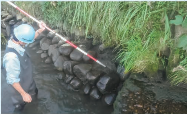
玉石積み護岸の崩れ状況 (H27.9.29)
