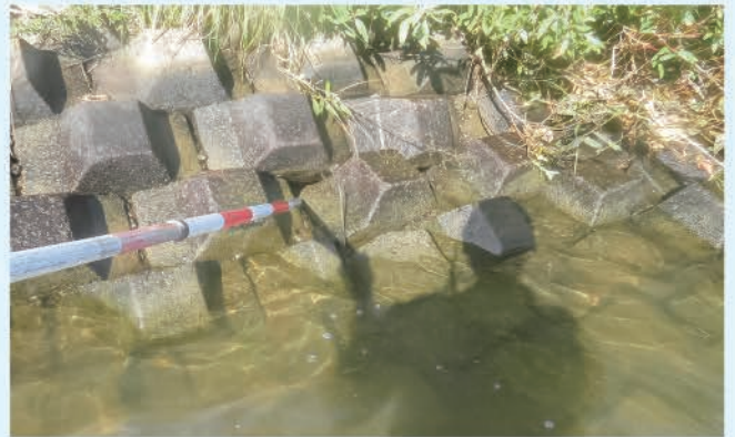
ブロック護岸変形状況 (H27.9.29)
