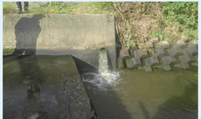
エプロン漏水状況 (H27.9.29)
