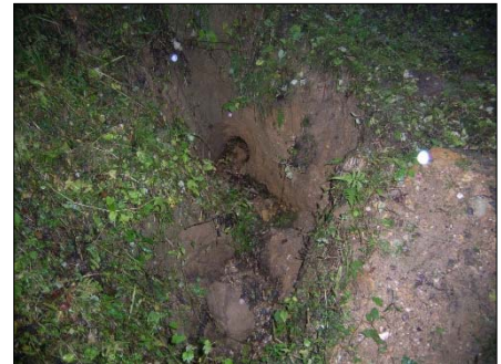
陥没漏水状況 (H19) 堤体右岸側の洪水吐横
