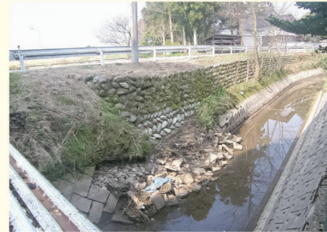
ブロック積擁壁の目地切れ
