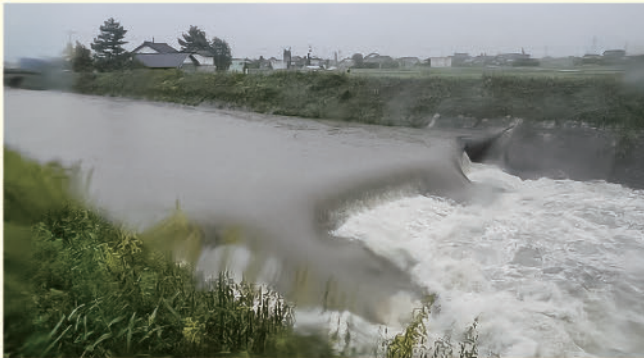
袋体の倒伏不良状況
