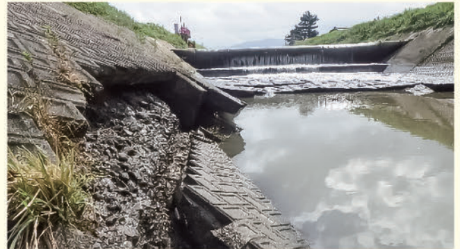
護岸ブロックの崩落状況
