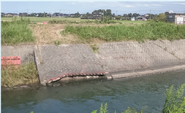
右岸下流護岸ブロック状況
