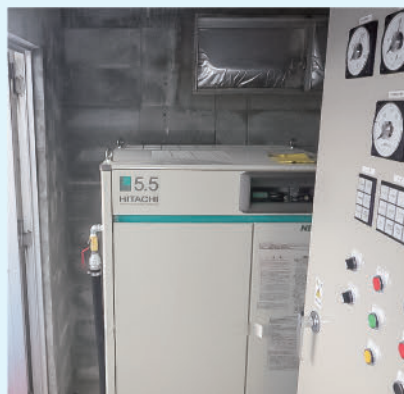
コンプレッサー
