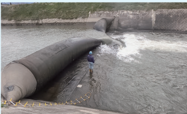
ゴム袋体倒伏不良状況
