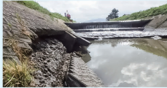
護岸ブロックの崩落状況
