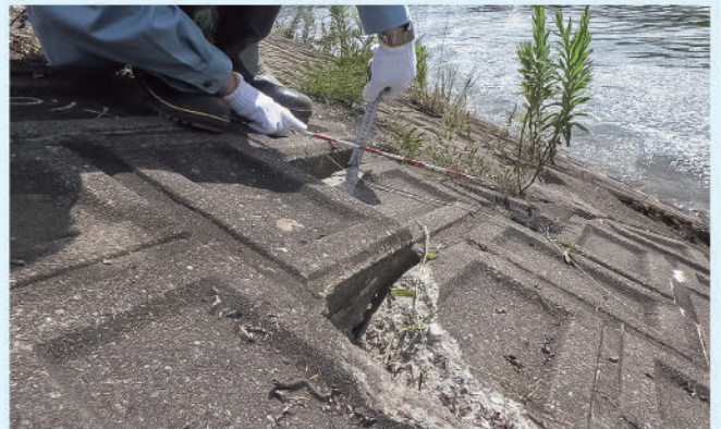
ブロック護岸変形状況
