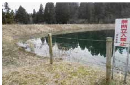
下流法尻からの漏水状況
