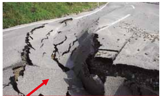
H17年4月パイプラインから漏水し、道路陥没
